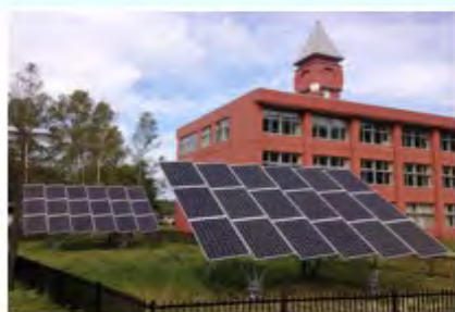
避難所に設置した太陽光発電
