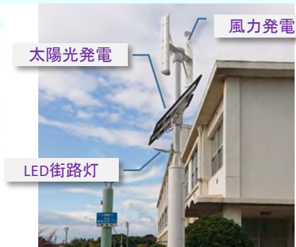
太陽光風力発電式街路灯 （避難施設等の敷地内）
